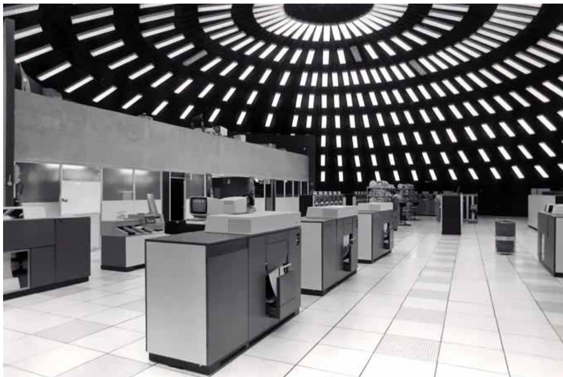
Centro de Processamento de Dados (CPD) da Prodesp - Companhia de TI do Estado de São Paulo
